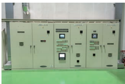
◆ システム制御盤
