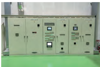
◆ システム制御盤
