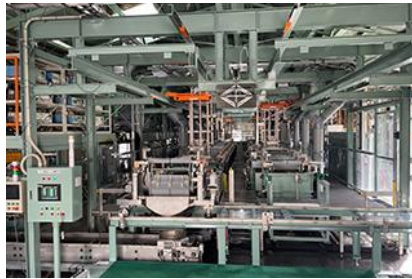
天井走行キャリア式バレルめっき装置
